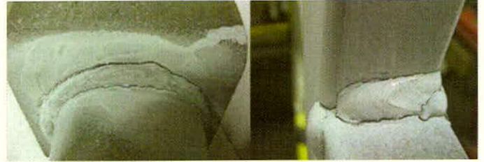
Resim 2. Kaynaklı birleşimlerde hasar oluşumları
