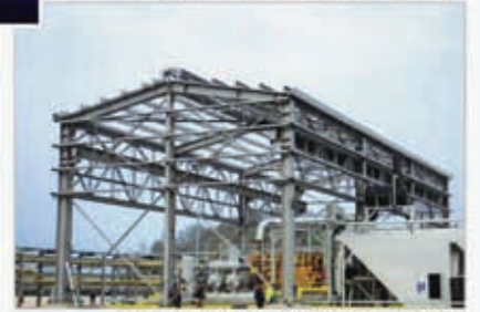
DOĞALGAZ POMPA BİNASI / EREĞLİ
