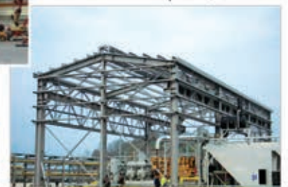
DOĞALGAZ POMPA BİNASI / EREĞLİ
