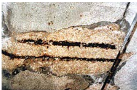
Korozyona uğramış betonarme
