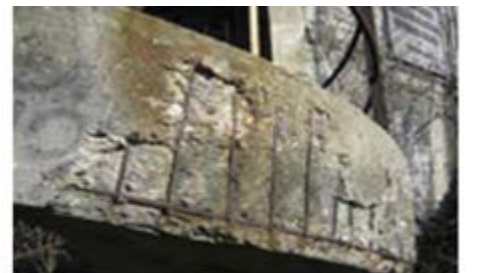
Korozyona uğramış beton ve donatı demirleri
