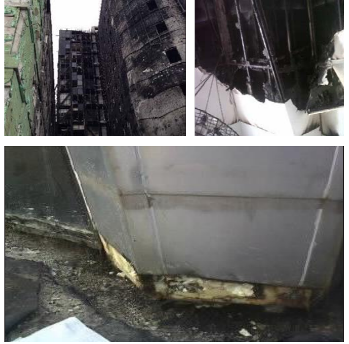
Resim 3. Yangın sonrası yapı malzemeleri
